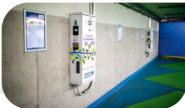
Die Stadtwerke Heidelberg Garagen engagieren sich für den Ausbau der Elektro-Ladeinfrastruktur in ihren Parkhäusern und Anwohnergaragen.
