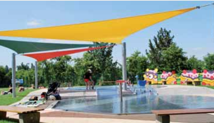
Beim Abriss des bestehenden Beckens kommen noch Reste des allerersten Planschbeckens aus dem Jahr 1939 zu Tage.
