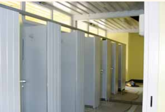
Die heutigen Umkleekabinen aus Thermoholz sind dem Original nachempfunden. Das neue Material widersteht der Feuchtebelastung besonders gut.
